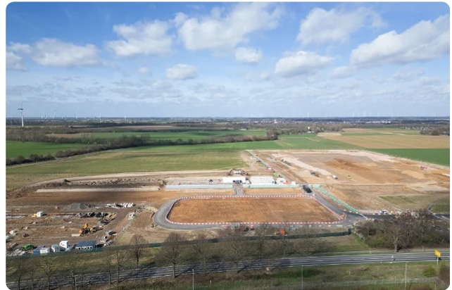
Store investeringer: Anleggsarbeidet er i gang for et nytt Microsoft-datasenter i Bergheim i Tyskland. Et av flere nye anlegg som skal styrke selskapets kapasitet innen skytjenester og AI. Foto: Andreas Rentz/Getty Images.
